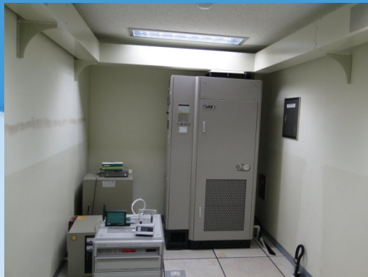
수소시계실 HVAC 공조기, 제어기
